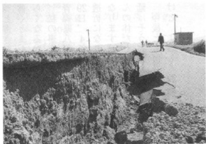
新潟中越地震で大きく亀裂が入った道路
